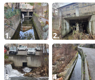
CANAUX DE DÉTOURNEMENT DE L'EAU
