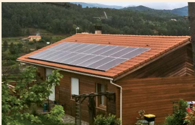
Installation sur maison individuelle
