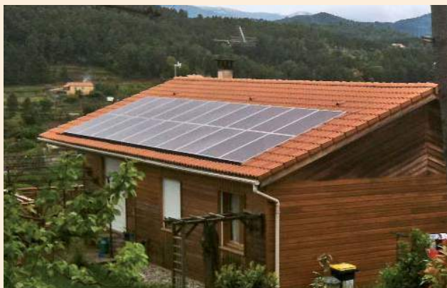
Installation sur maison individuelle
