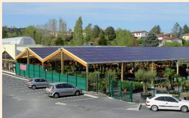
Installation sur bâtiment commercial
