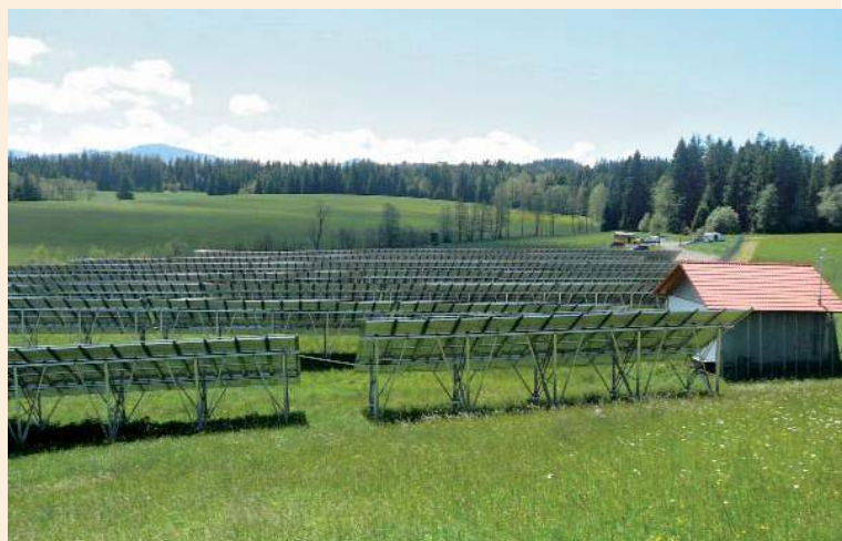
Centrale photovoltaïque au sol en zone agricole
